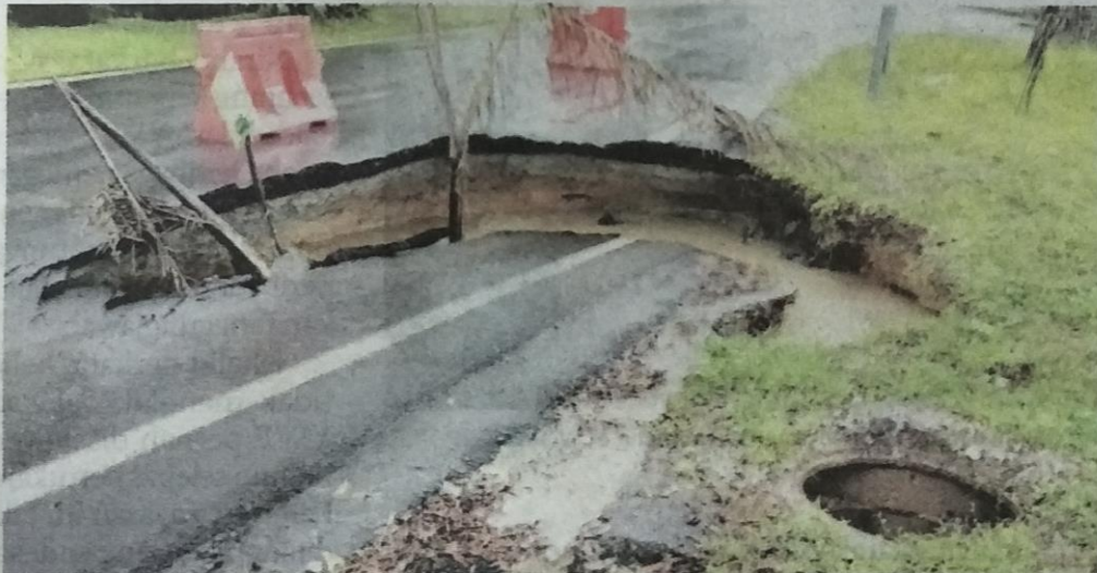
Keadaan jalan mendap di Jalan Puteri 3 selepas hujan lebat semalam.
