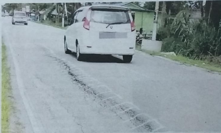
Jalan utama di Kampung Perigi Nenas mendap sejak lima bulan lalu, sekali gus membahayakan nyawa pengguna terutamanya penunggang motosikal.
